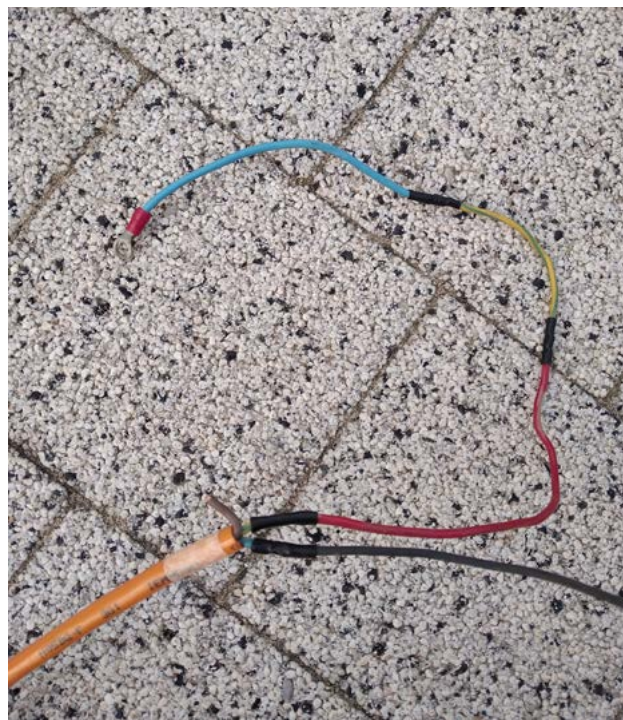
Fot. 11 Po 40 latach główny kabel zasilający składał się z 7 odcinków
